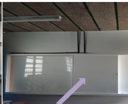
Painel central fechado, para uso do quadro branco e com TV protegida
